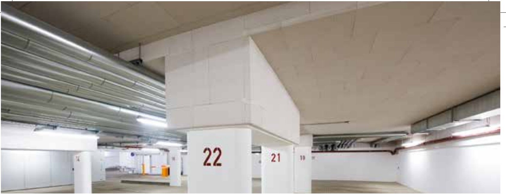
Leipzig Üniversitesi otopark tavanı uygulaması: karanlık sığınak görünümü geçmişte kaldı - Mineral Esaslı Multipor Isı Yalıtım Levhaları aydınlık ve sıcak bir atmosfer sağlar.
